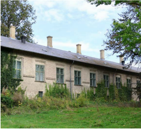
Fig.20. Sydfacaden af Bygning 32 - her ses udformning og detaljering af eksisterende vinduer. © ERIK arkitekter
