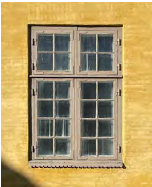
Fig.21. Her ses eksisterende korspostvindue med hjørnebåndshængsel, sprosser med kitfals. Karakteristiske sålbænke i zink med klippet blondkant. © Peter Kjær Arkitekter
