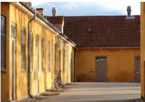
Fig.26. Her ses de eksisterende tag- og nedløbsrønder i zink. I Østlængens sydfacade ses nye ventilationsudtag i tagfladen som skal nedrives og erstattes af skorstene som oprindeligt. © Per Lund
